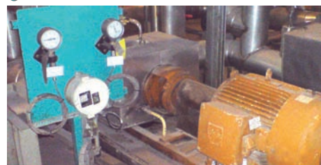
4 Зачистной насос L4NG для сырой нефти
