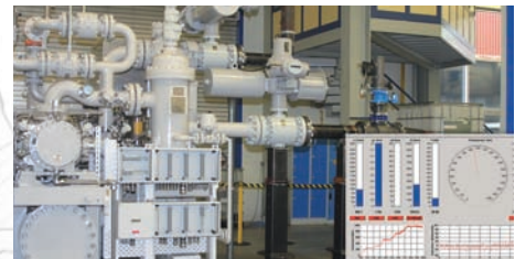
Испытательный стенд мультифазных насосов
