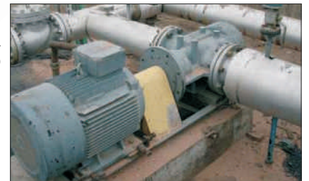
2 3 FO Насос перемещения L3NG
